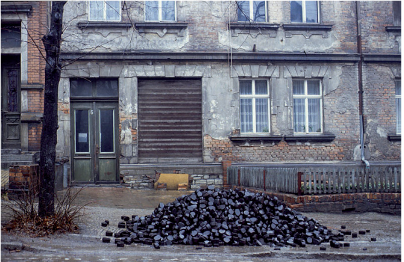
Folge der Mietpreisbindung in der DDR Verfallenes Haus mit Kohleheizung in Merseburg 1980
